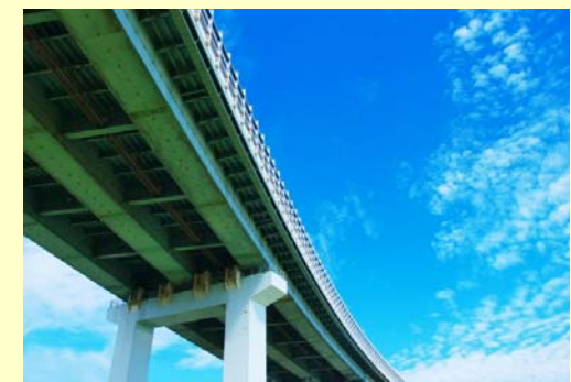
大規模な橋梁のクラック検査も1人で行うことが可能
